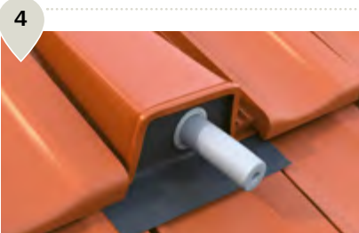
Trecere țevi panouri fotovoltaice
