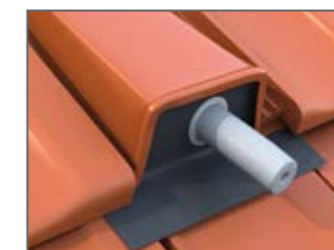
25 Trecere țevi panouri fotovoltaice
